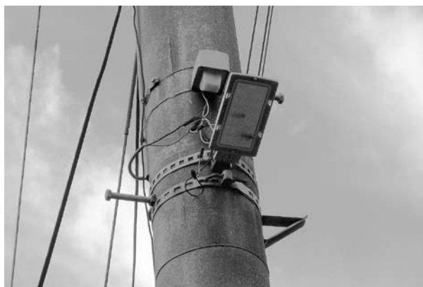
防犯灯のLED化（摂津市）
